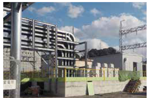
▲液状化対策例:構内変電所設備のリニューアル
