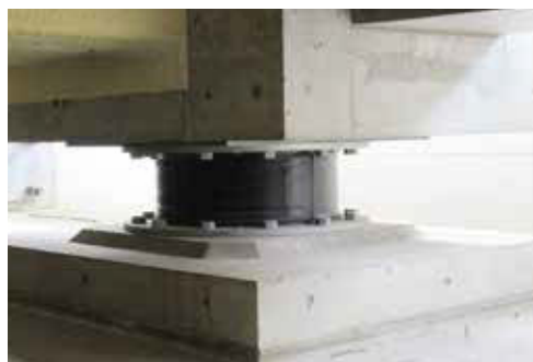
新本館の防災設備:免震ゴム▶
